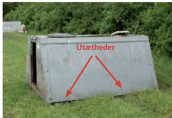
Uheldig placering af hytten. Det ujævne terræn gør, at regnvand løber ind i hytten. Foto: Heidi M. Andersen
